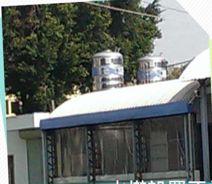
水塔設置不當 未設置安全上下設備
