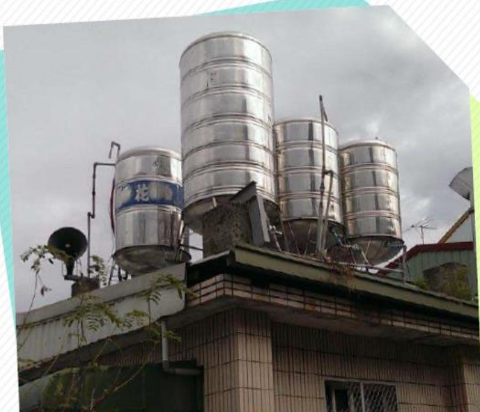
水塔、鍋爐油槽設置不當 未設置安全上下設備
