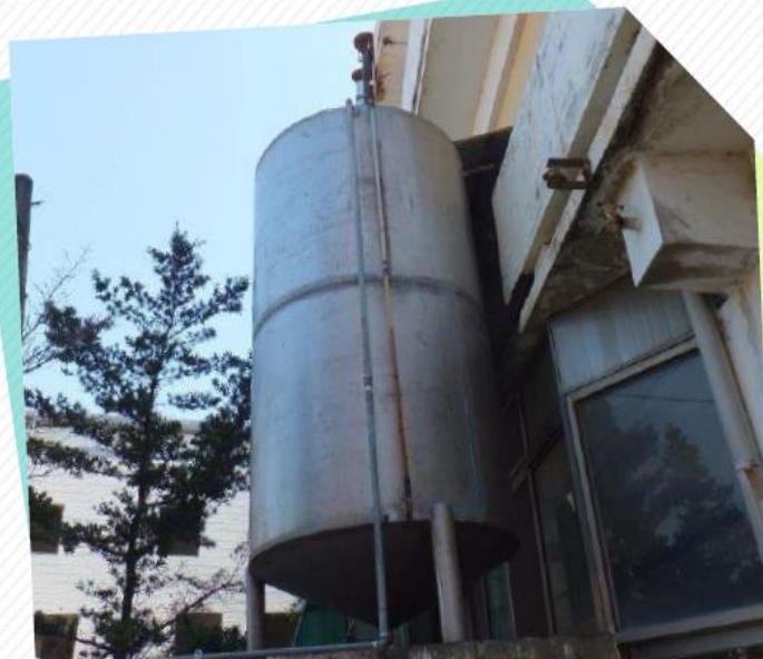
鍋爐油槽設置不當 未設置安全上下設備
